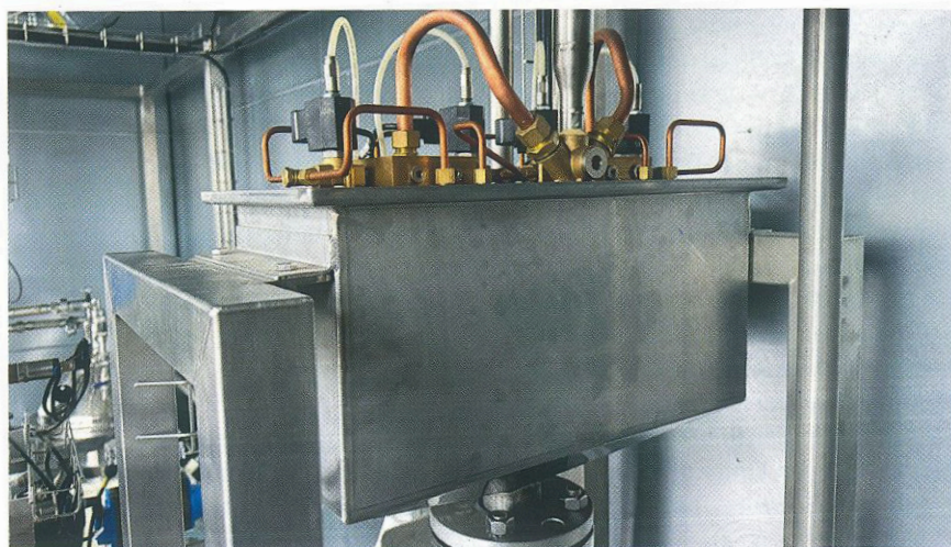
In der Heion-Reaktorzelle läuft die Umwandlung des Diesels ab.
